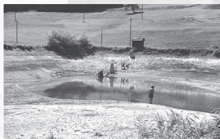
Trockenlegung des Ringwilerweiher für Unterhaltsarbeiten; u.a. an den beiden Schiebern für den Grundablass und die Druckleitung (1956).
